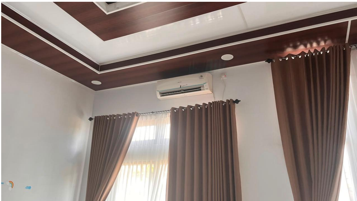
Tersedia AC di ruang tunggu untuk pendingin ruangan
